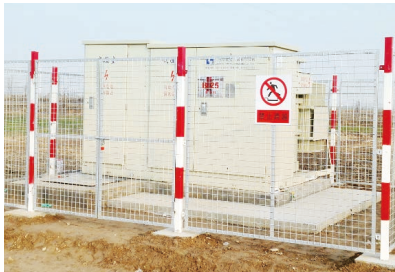
在设备区装设安全警示牌
