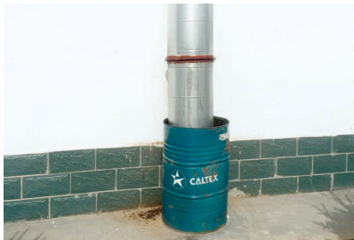
厨房油烟收集设施
